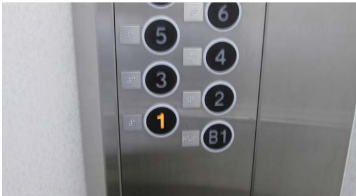
・エレベーター
